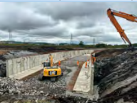
Canalização do Córrego Tanquinho, localizado em Jacareí-SP - Projeto e Consultoria: H PROJ
